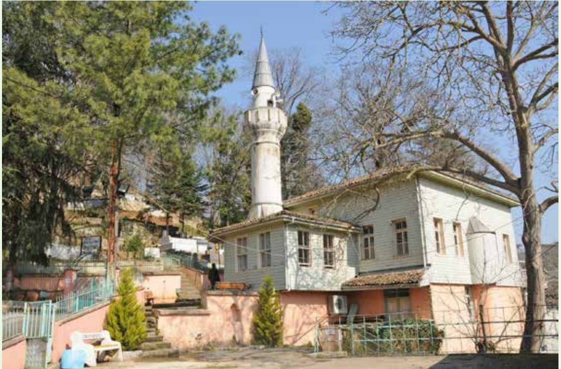
Akbaba köyündeki Canfeda Hatın Camii depremde hasar gören binalar arasındaydı.
